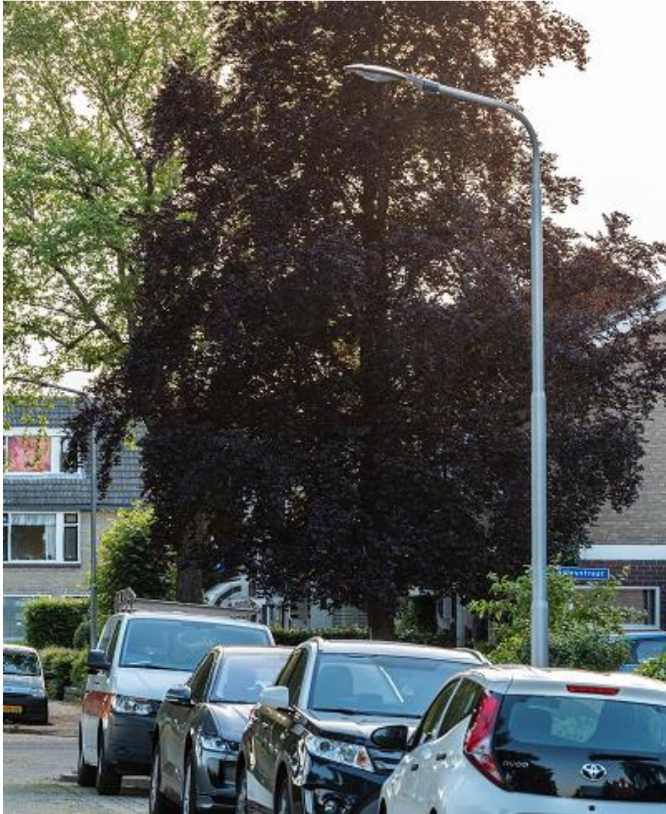
(Ipv getoonde flespaal: conische mast)
