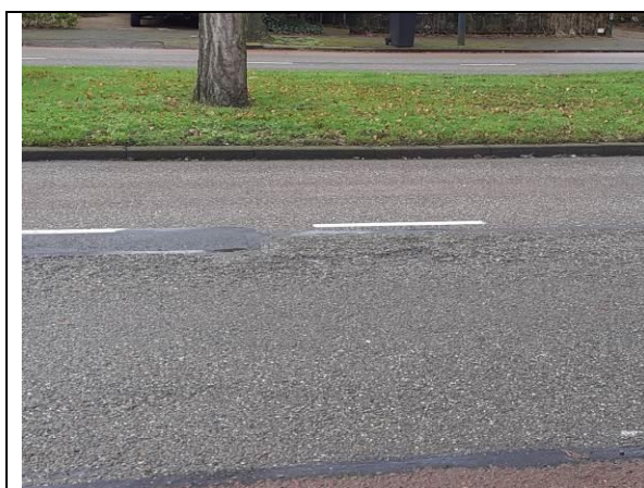
Licht tot plaatselijk matig/ernstige rafeling (tot gaten aan toe)
