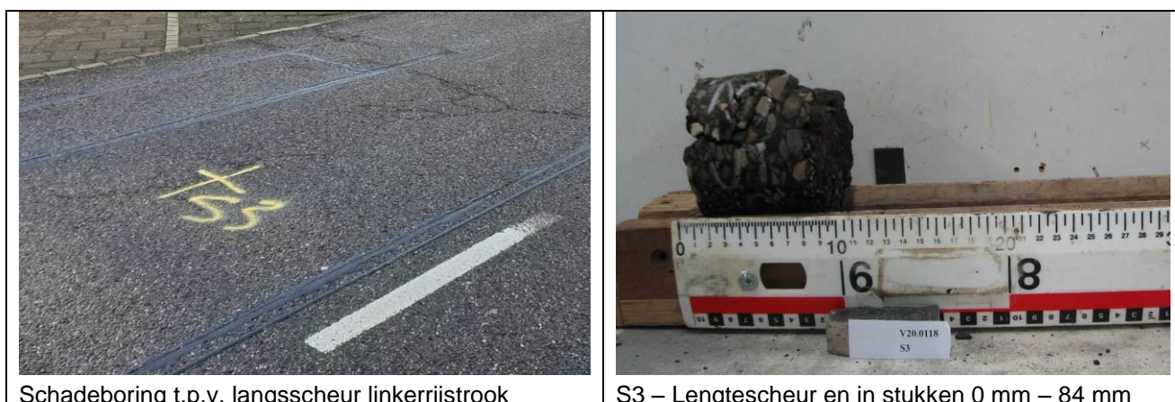
Figuur 23 Schadeboring S3 + de asfaltkern op de Pieter Aertzlaan
