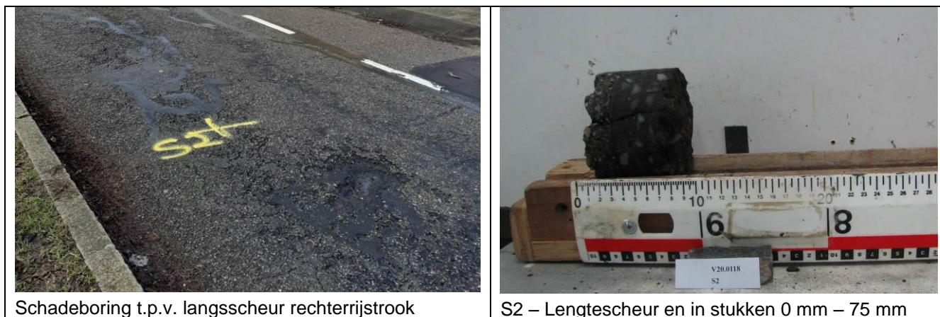
Figuur 22 Schadeboring S2 + de asfaltkern op de Pieter Aertzlaan
