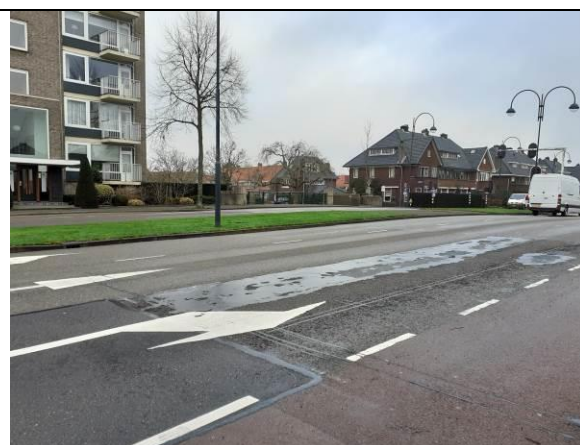
Reparatievak deels gerepareerd met koud asfalt, ernstige rafeling tot aan gaten toe, in 2020
