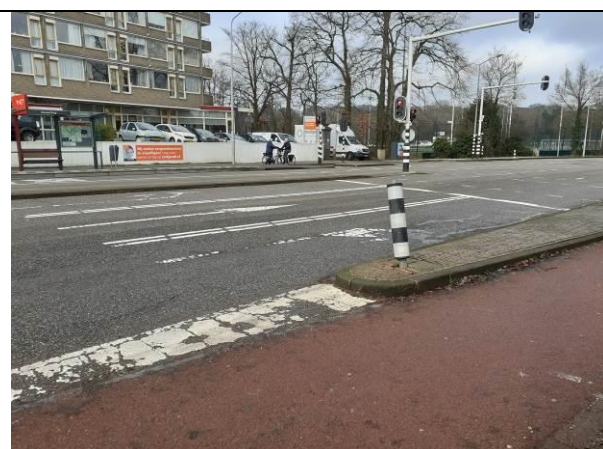
Langsscheur t.p.v. opstelstrook naar Churchillaan
