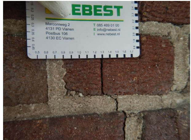
Foto 4.15: Verticale scheur metselwerk (1,3 mm)
