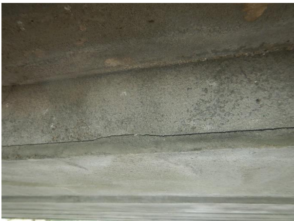
Foto 4.7: Reparatie onthecht en losgescheurd
