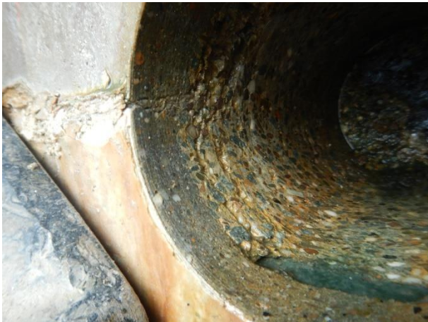
Foto 5.1: Onderzoekslocatie K1 en C1, beton achter reparatie gescheurd en brokkelt af
