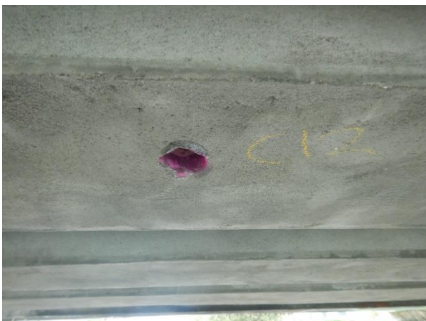
Foto 5.3: Onderzoekslocatie C2, dikte reparatie 20 mm
