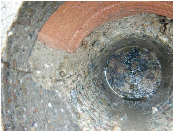
Foto 5.7: Onderzoekslocatie K2, corrosie lijf stalen ligger
