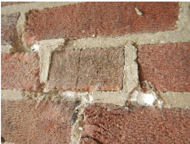
Foto 4.12: Voegwerk en stenen beschadigd
