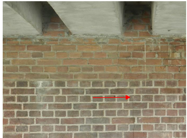
Foto 4.11: Verticale scheur metselwerk
