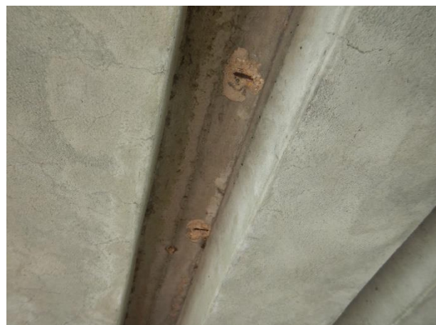
Foto 4.2: Kleine betonschades door wapeningscorrosie, weinig dekking op wapening
