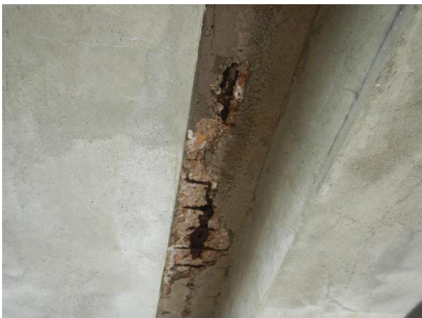
Foto 4.9: Afgedrukt beton met wapeningscorrosie ter plaatse van stalen buis in beton
