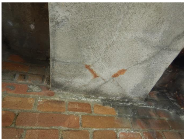
Foto 4.1: Scheuren met roestuitbloeiingen op aansluiting met landhoofd
