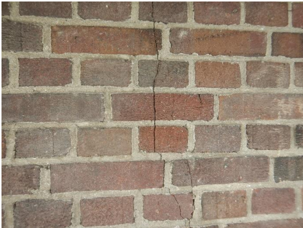
Foto 4.14: Verticale scheur metselwerk
