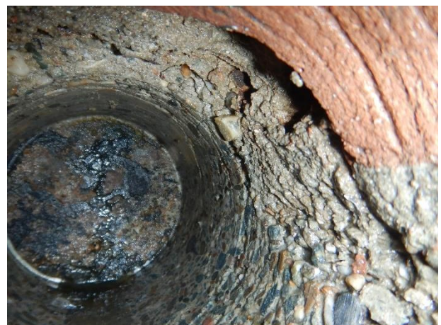
Foto 5.6: Onderzoekslocatie K2, beton achter reparatie gescheurd en brokkelt af
