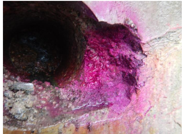
Foto 5.2: Onderzoekslocatie K1 en C1, beton afgebrokkeld en niet gecarbonateerd
