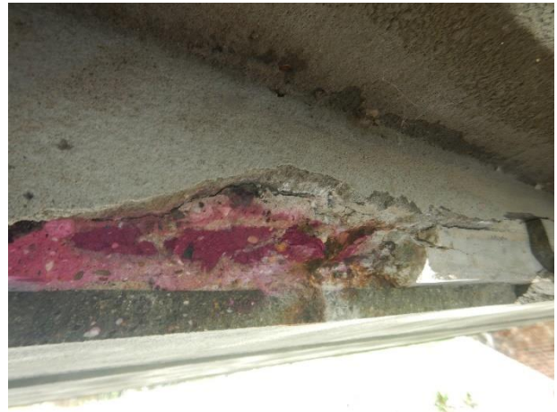
Foto 5.8: Onderzoekslocatie C5, beton tot wapening gecarbonateerd, wapening gecorrodeerd
