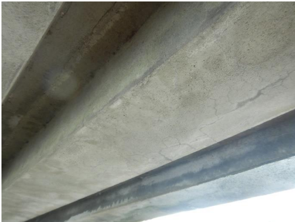
Foto 4.5: Craquelé scheurenpatroon in reparatie
