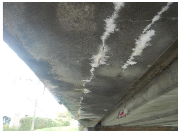
Foto 4.8: Scheuren in langsrichting met witte uitbloeiingen
