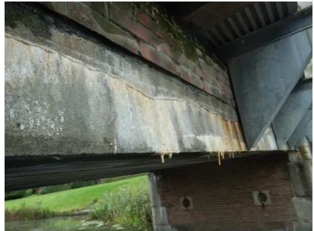
Foto 4.6: Horizontale scheuren, witte en bruine uitbloeiingen zijkant dek
