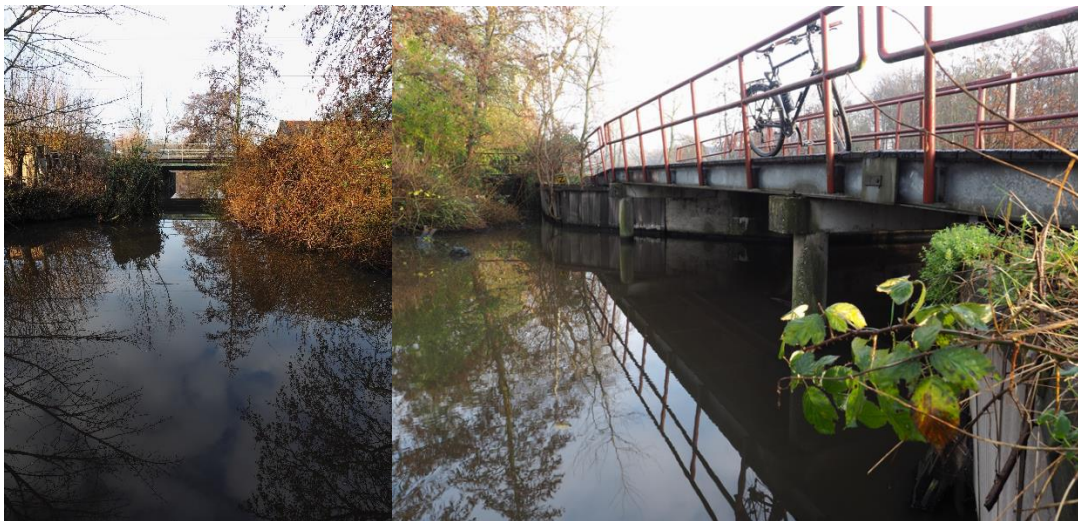
Figuur B3-3 Het ontbreken van treeplanken in de overkluizingen onder spoor en Leidsevaartweg
