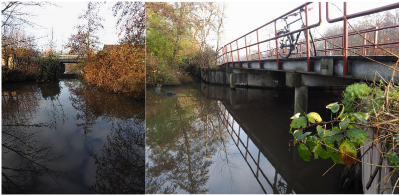
Figuur B3-3 Het ontbreken van treeplanken in de overkluizingen onder spoor en Leidsevaartweg
