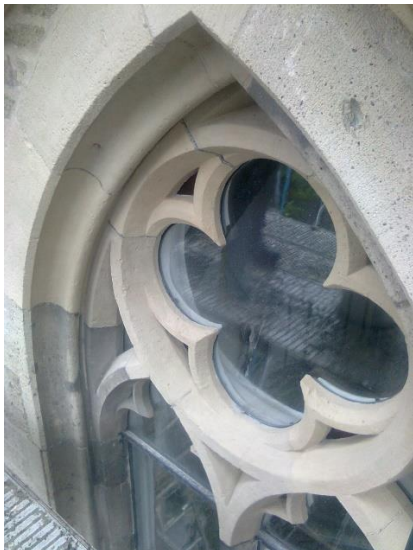
Delen van dit tufstenen venster (bovenin links en in het midden) aan de Dom van Xanten zijn behandeld met een kalklaag om te tufsteen te verduurzamen.
