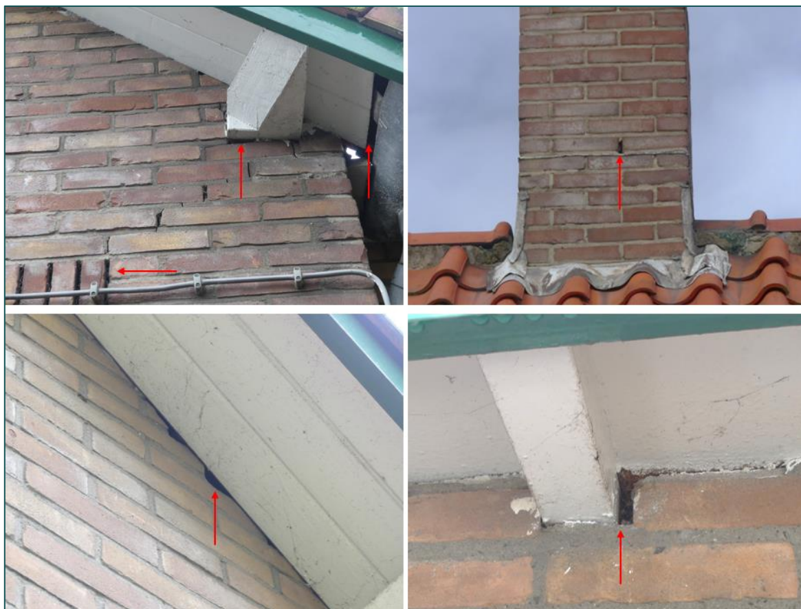
Figuur 3.1 Impressie van potentiële invliegopeningen voor vleermuizen in de te slopen woning.
