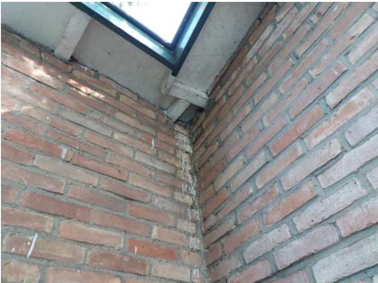
Figuur 19: Noordgevel van de woning Duin en Vaart 12, met in de hoek van twee muren onder het dakoverstek de sporen van overnachtende boomkruipers. Foto: 13 mei 2023.
