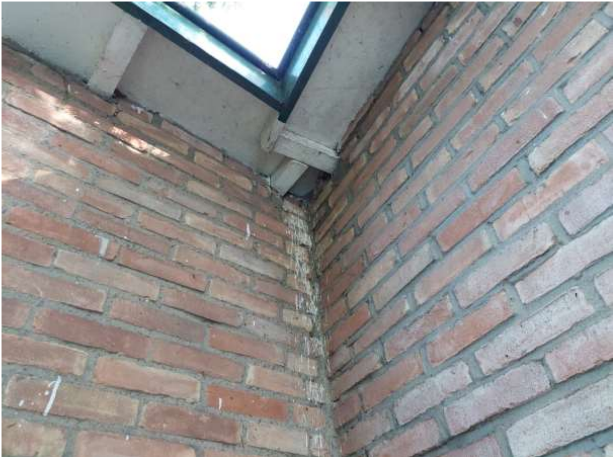
Figuur 19: Noordgevel van de woning Duin en Vaart 12, met in de hoek van twee muren onder het dakoverstek de sporen van overnachtende boomkruipers. Foto: 13 mei 2023.
